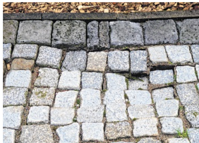
Durch die Wassermengen hat sich auch das Pflaster auf dem Gehweg bereits abgesenkt.
