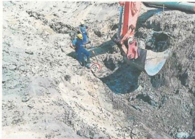
7.300 Kilometer marode Entwässerungsgräben müssen in den kommenden Jahren überall im Land instand gesetzt werden. FOTO: WBV
