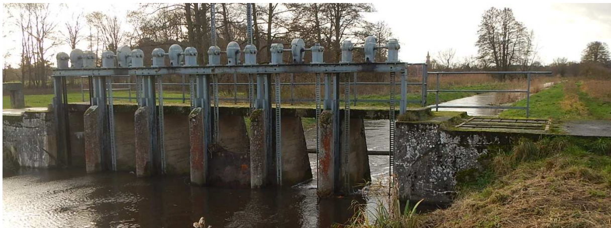
Abbildung 5.7: Wehr Redefin im Herbstbetrieb (Foto vom 19.11.2015) – vierte Tafel gezogen
