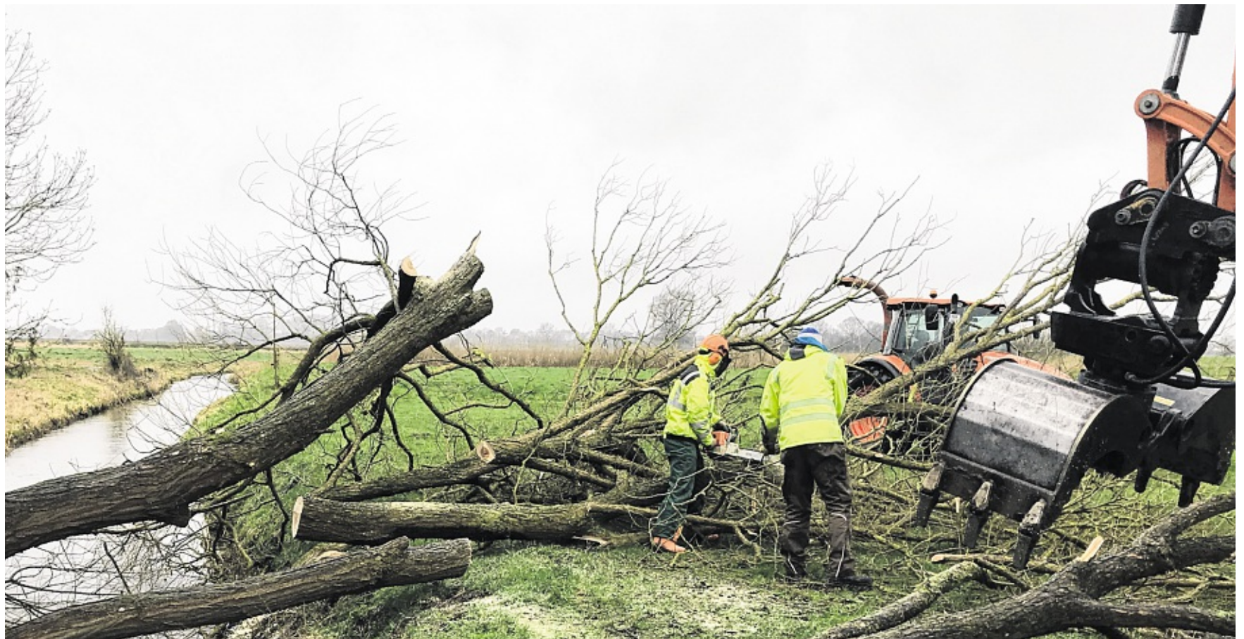
Mitarbeiter der Firma „Owszak“ borgen gestern die in den Fluss Motel gestürzte Weide, um ein Anstauen des Wassers zu verhindern.
